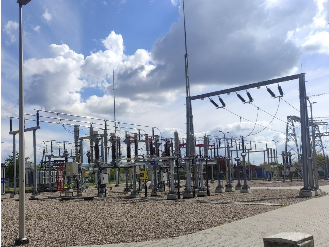
Zdjęcie nr 1. Stacja transformatorowa 110/15 kV GPZ Choszczno I– widok fragmentu obiektu
