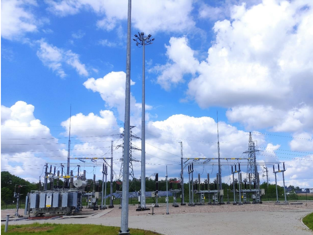
Zdjęcie nr 1. Stacja transformatorowa 110/15 kV GPZ Choszczno II – widok fragmentu obiektu.
