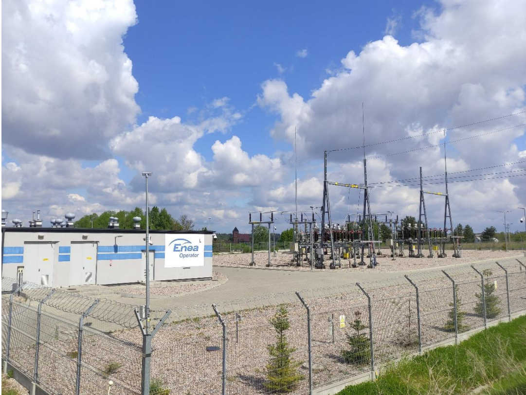
Zdjęcie nr 1. Stacja transformatorowa 110/15 kV GPZ Recz – widok fragmentu obiektu
